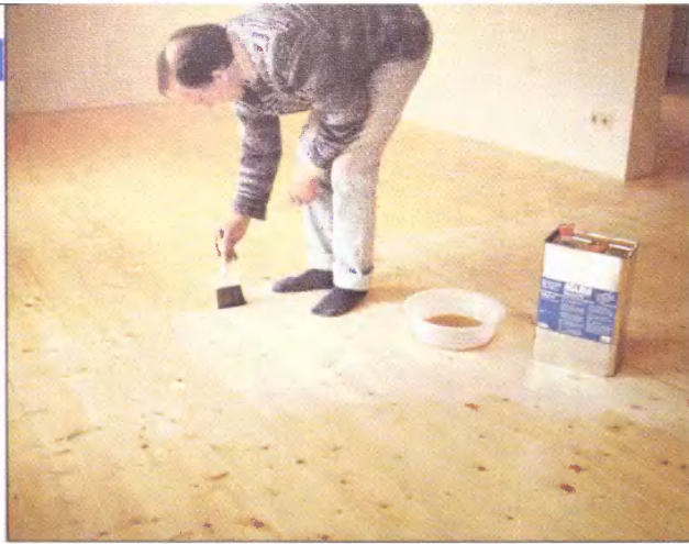
Грунтовку наносим широкой кистью в один слой, начиная от дальней стены по направлению к выходу.
