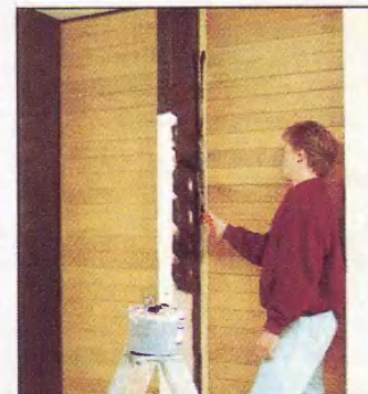
Черный цвет контрастирует с фоном из светлого дерева. Краску наносим валиком в два слоя.
